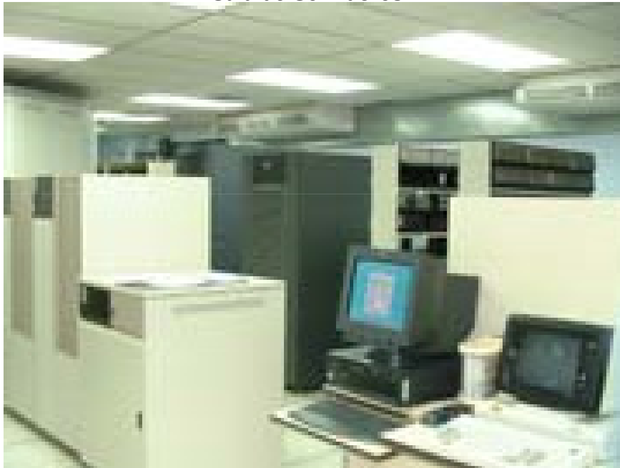
Sala de Servidores
